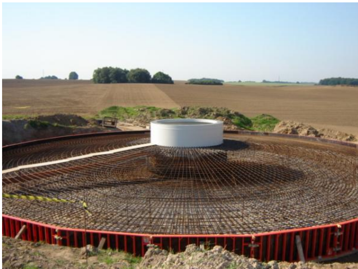
Fot.1. Przykład zbrojenia fundamentu elektrowni wiatrowej (farma wiatrowa w Tymieniu, woj. zachodniopomorskie) 3
