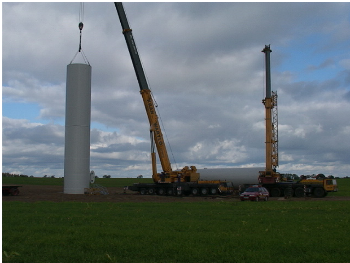
Fot. 2. Montaż wieży elektrowni wiatrowej z gotowych elementów (farma wiatrowa w Tymieniu, woj. zachodniopomorskie). 4
